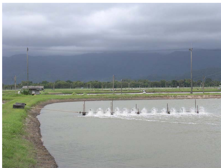
ภาพที่ 8 ลักษณะการวางเครื่องให้อากาศระบบที่ 2
