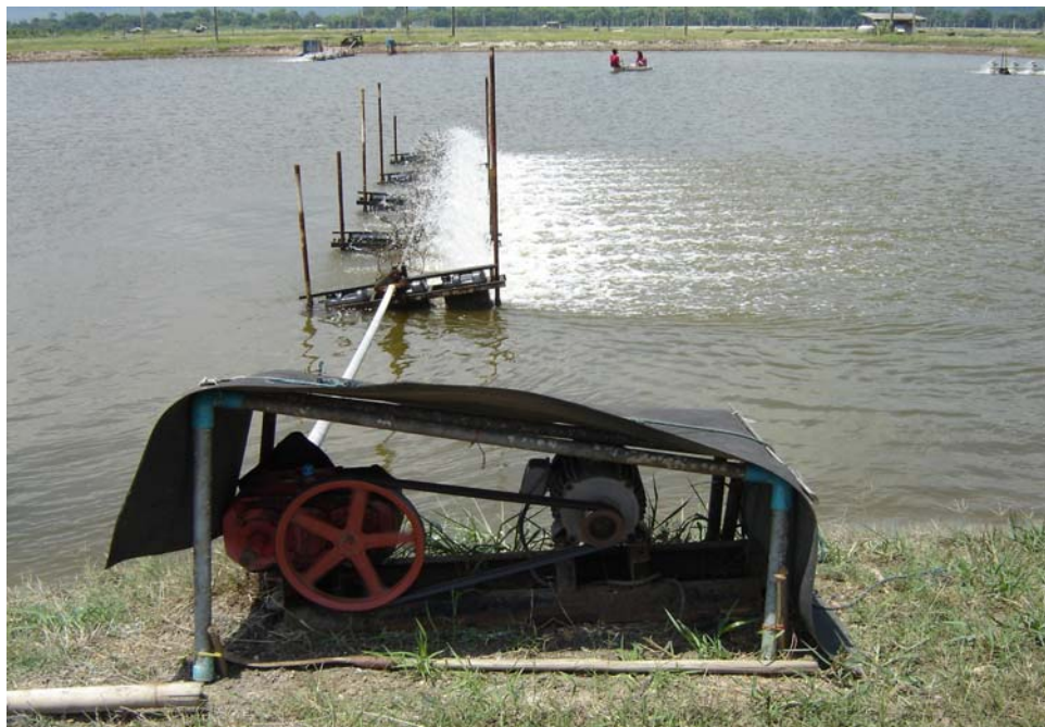
ภาพที่ 5 มอเตอร์ไฟฟ้าขนาด 2 แรงม้าของการวางเครื่องให้อากาศระบบที่ 2
