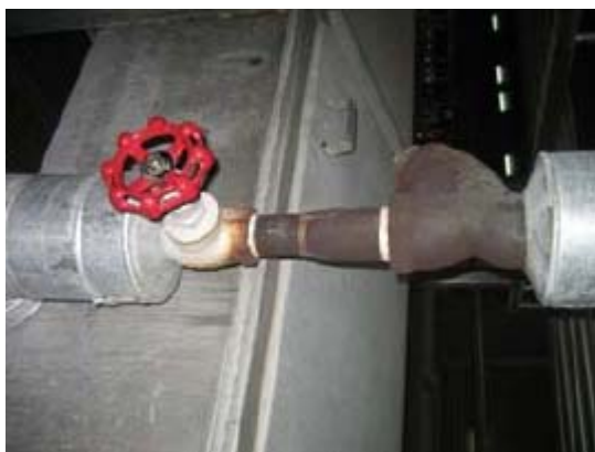
ภาพที่ 4.5-2 ท่อไอน้ำที่ไม่ได้หุ้มฉนวน
