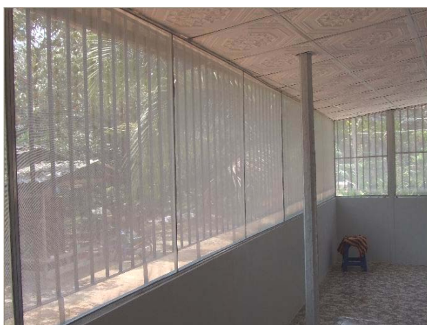
ภาพที่ 55 กลุ่มแม่บ้านเกษตรกรหนองอ้อ: อาคารผลิตมีมาตรการป้องกันการปนเปื้อนจากสัตว์และแมลงโดยติดมุ้งลวดรอบอาคารผลิต แต่เพดานอาคารผลิตยังไม่เรียบ เนื่องจากใช้แผ่นฝ้าที่มีรอยร้าวทำให้ยากต่อการทำความสะอาด
