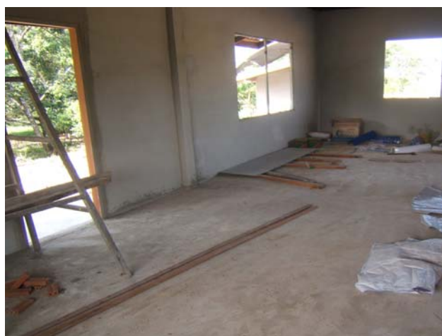
ภาพที่ 10 กลุ่มแม่บ้านเกษตรกรบ้านน้ำโจน: อยู่ในระหว่างการจัดสร้างโรงเรือนใหม่ยังไม่มีมาตรการป้องกันการปนเปื้อนจากสัตว์และแมลงเข้ามาในอาคารผลิต
