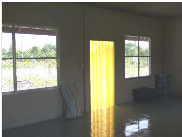
ภาพที่ 58 กลุ่มแม่บ้านเกษตรกรบ้านน้ำโจน: อาคารผลิตมีมาตรการป้องกันการปนเปื้อนจากสัตว์และแมลงโดยการติดม่านกันแมลงบริเวณประตูทางเข้าอาคารผลิต และทำการติดตั้งมุ้งลวดบริเวณหน้าต่างและช่องเปิดรอบอาคารผลิต
