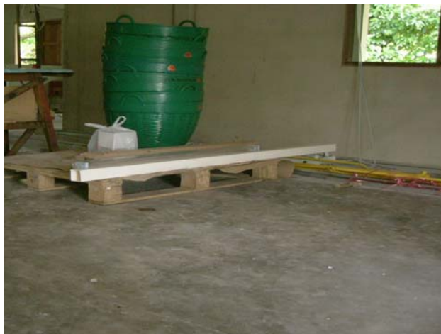
ภาพที่ 5 กลุ่มแปรรูปน้ำสมุนไพร: อยู่ในระหว่างการสร้างอาคารผลิตน้ำสำรองกระป๋อง แต่พื้นที่อาคารผลิตยังไม่มีท่อหรือทางระบายน้ำออกนอกอาคารเพื่อระบายน้ำทิ้งทำให้เสี่ยงต่อการเกิดน้ำขังแฉะ
