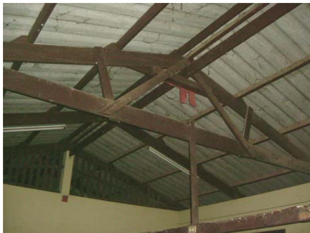
ภาพที่ 11 กลุ่มอาชีพสตรีบ้านท่าเขา: เพดานอาคารผลิตไม่เรียบไม่มีฝ้าเพดาน ไม่สะอาด รวมทั้งอุปกรณ์สิ่งที่ยึดติดอยู่ด้านบนอาจก่อให้เกิดการปนเปื้อน
