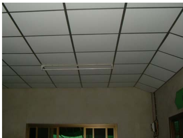
ภาพที่ 12 ร้านแม่เอ็นดู: หลอดไฟที่ใช้ในอาคารผลิตไม่มีฝาครอบอาจก่อให้เกิดการปนเปื้อนได้
