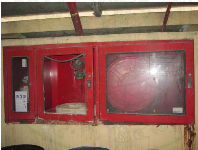
ภาพที่ 29 ตู้ฉีคน้ำดับเพลิงชำรุด
