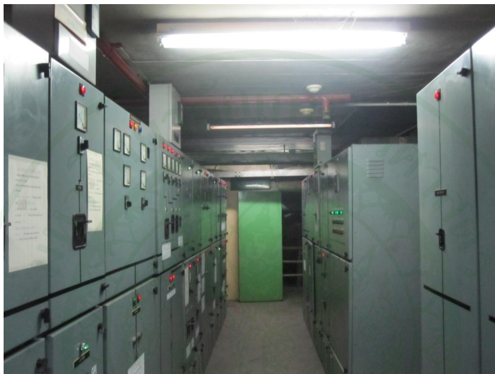
ภาพที่ 38 สารสะอาด HFC-227ea แบบครอบคลุมทั้งห้องในห้องควบคุมไฟฟ้า
