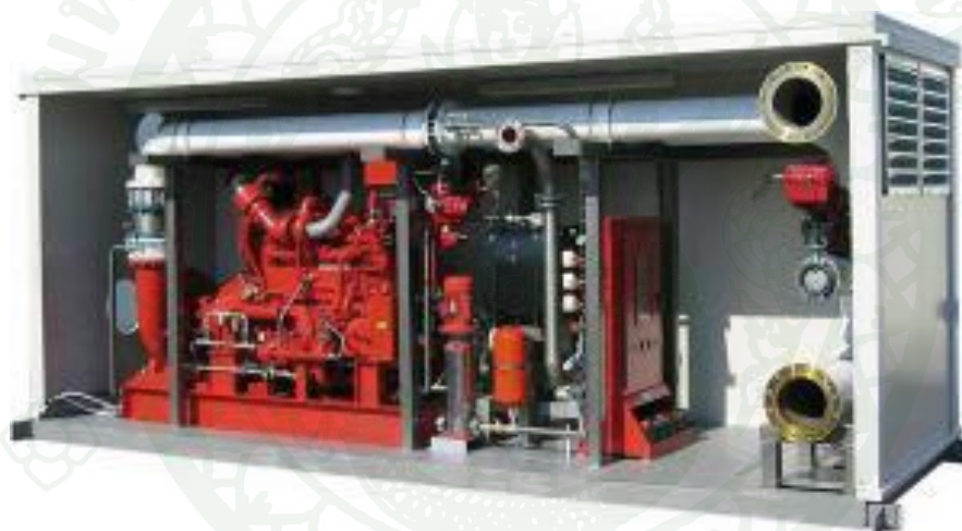
ภาพที่ 13 ต้นกำลังเครื่องสูบน้ำดับเพลิง
