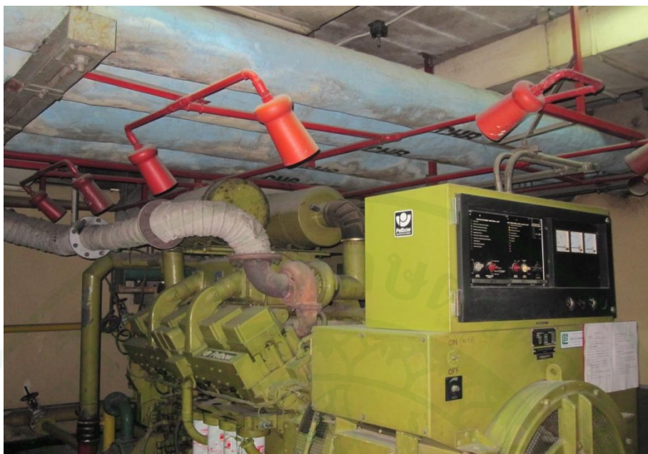
ภาพที่ 37 สารเคมีก๊าซคาร์บอนไดออกไซด์ นีดเฉพาะจุดในห้องเครื่องยนต์
