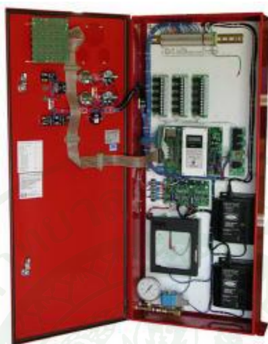
ภาพที่ 17 ตู้ควบคุมเครื่องสูบน้ำดับเพลิง (Fire Pump Controller)
