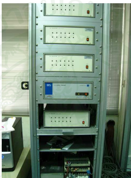
ภาพที่ 24 ตู้ควบคุมภายในประกอบด้วยอุปกรณ์ควบคุมในการวัดและบันทึกผลด้วยคอมพิวเตอร์
