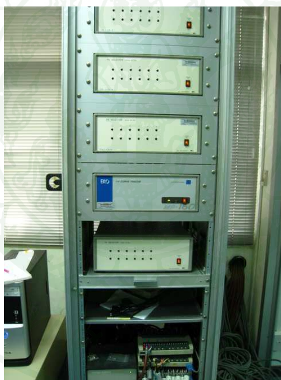
ภาพผนวกที่ 8 ตู้เก็บอุปกรณ์ควบคุม
