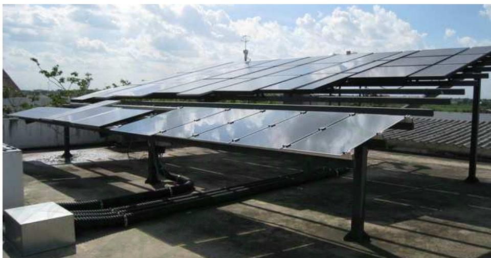
ภาพที่ 22 แผงเซลล์แสงอาทิตย์และอุปกรณ์ที่ใช้วัดค่าภายนอกอาคาร
