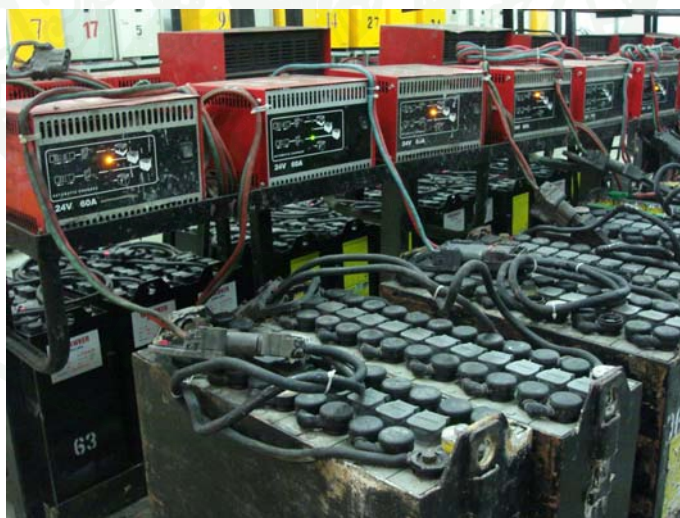
ภาพที่ 4 การประจุไฟฟ้าแบตเตอรี่ รถยก-รถลาก
