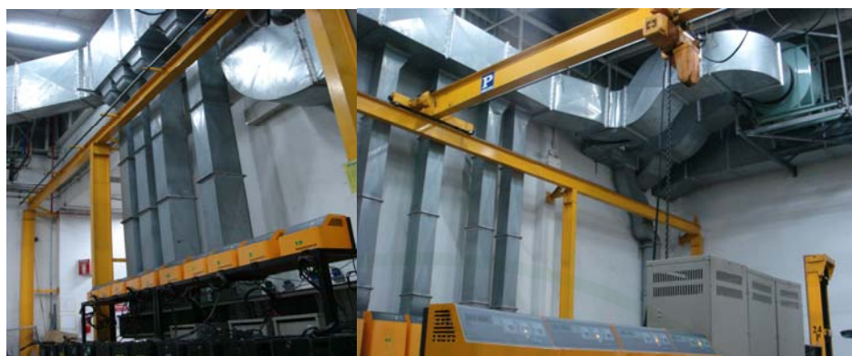
ภาพที่ 27 ระบบระบายอากาศในห้องประจุแบตเตอรี่
