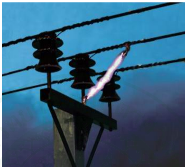
ภาพที่ 23 การเกิด Flashover บนระบบจำหน่ายไฟฟ้า
