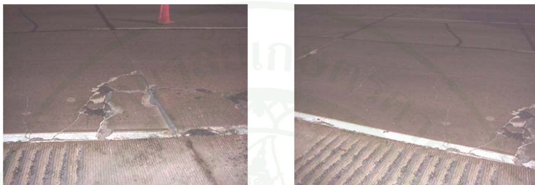
ภาพที่ 59 แผ่นคอนกรีตที่มีรอยแตกบริเวณมุมแผ่น (FHWA, 2007)
