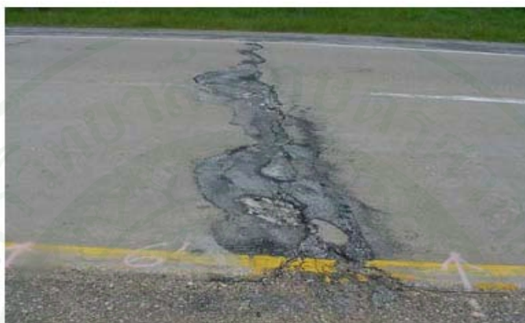
ก) รอยต่อเสื่อมสภาพ มีรอยกะเทาะและมีการปะซ่อม
