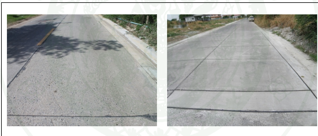
สภาพสายทางก่อนการซ่อมแซม
