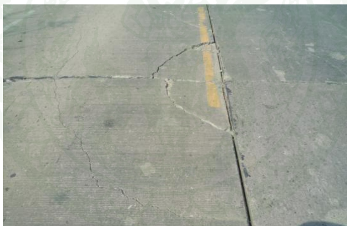
ภาพที่ 4 รอยแตกบริเวณมุม
