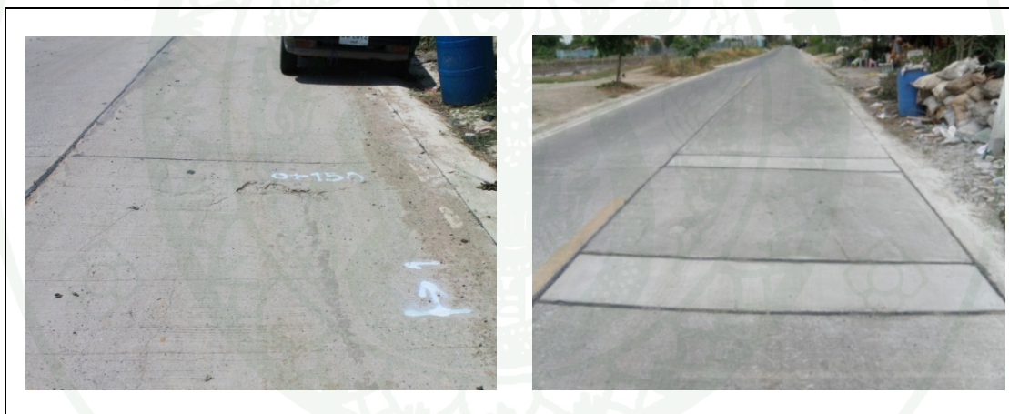
สภาพสายทางก่อนการซ่อมแซม
