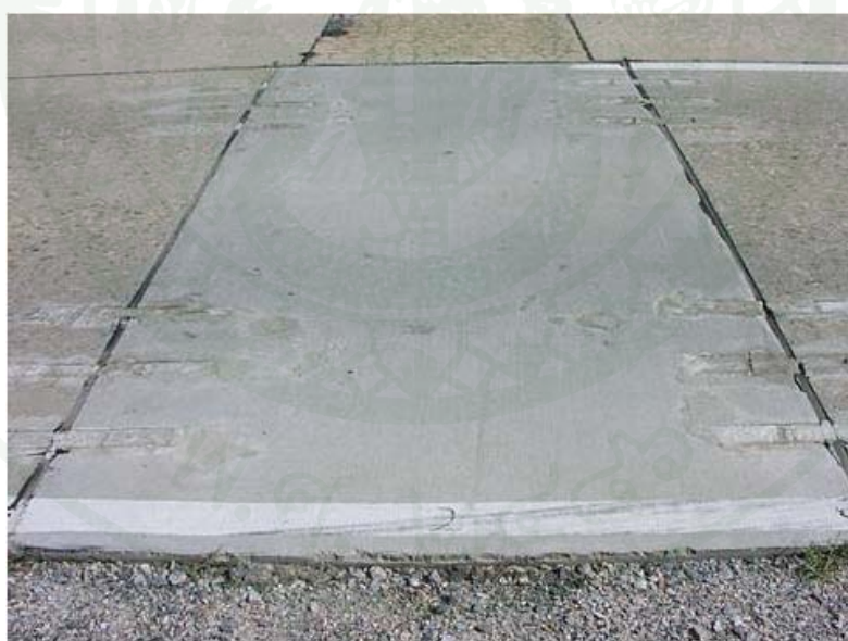
ภาพที่ 82 ตัวอย่างสภาพความเสียหายของแผ่นคอนกรีตที่ฝังเหล็กเคียวไว้ภายหลัง (Hosssain, 2006)
