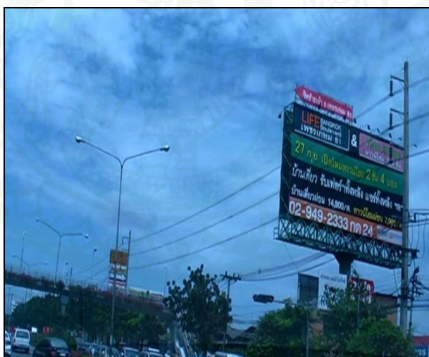
ภาพที่ 1 สายส่งจ่ายแรงดัน 69 เควี. บริเวณเพชรเกษม ของการไฟฟ้านครหลวง
