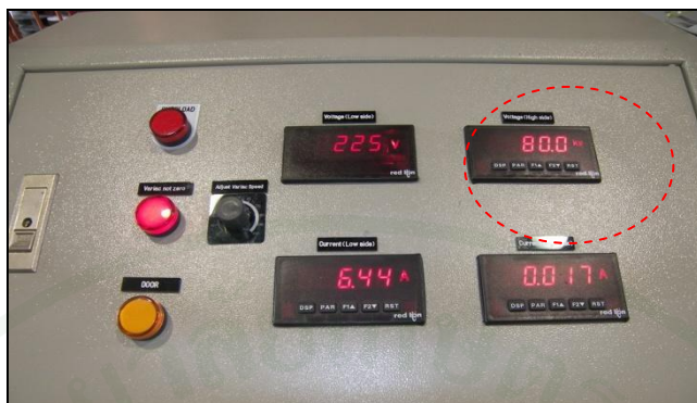
5.10 สังเกตกระแสด้านแรงดันสูงที่เพิ่มขึ้นด้านที่ออกจากหม้อแปลงจากมิเตอร์ ดังภาพข้างล่าง
