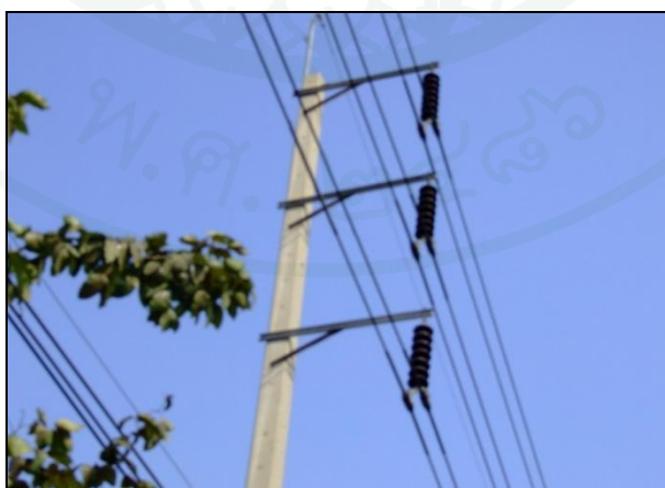
ภาพที่ 28 ลูกถ้วยแขวน(พอร์ชเลน) ที่ติดตั้งบนโครงสร้างทางผ่าน (TS-115) สายส่งระบบ 115 เควี. ของการไฟฟ้านครหลวง
