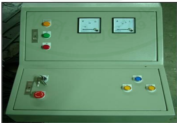
ภาพที่ 37 AC/DC Kilovolt Meter
