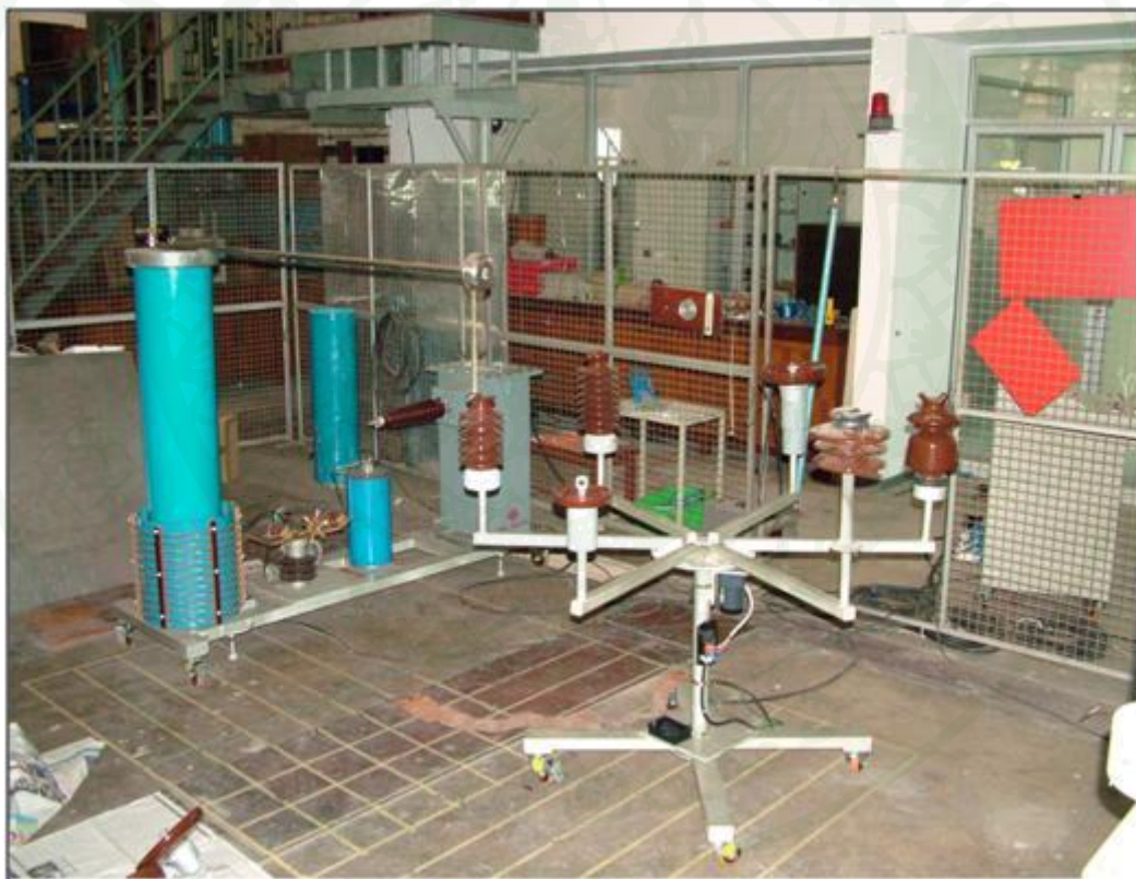
ภาพผนวกที่ ๓ เครื่องกำเนิดแรงดันสูงความถี่สูง
