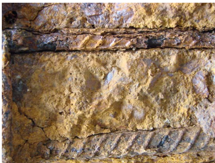
ภาพที่ 37 การลดลงของพื้นที่หน้าตัดของเหล็กเสริมเนื่องจากการเกิดสนิมของตัวอย่างรูปคาน
