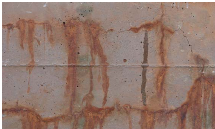
ภาพที่ 53 การเกิดสนิมของเหล็กเสริมของคานจิโอโพลิเมอร์คอนกรีตที่ระยะเวลา 28 วัน
