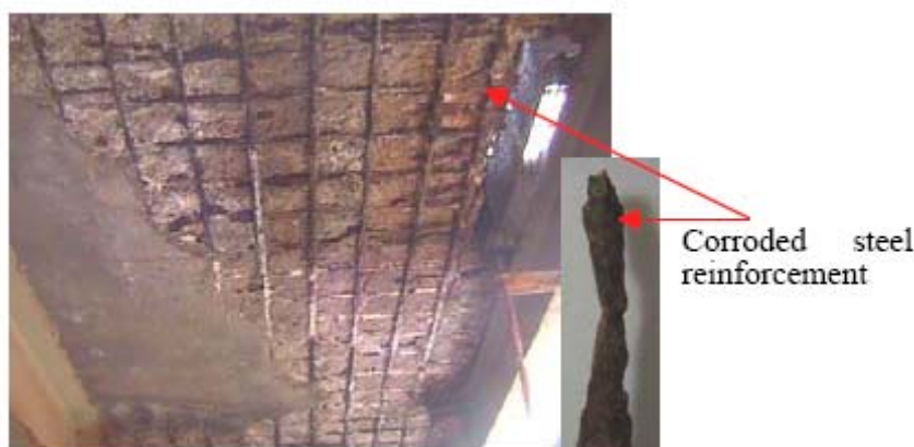
ภาพที่ 3 ความเสียหายของโครงสร้างคอนกรีตเนื่องจากการเกิดสนิมของเหล็กเสริม
