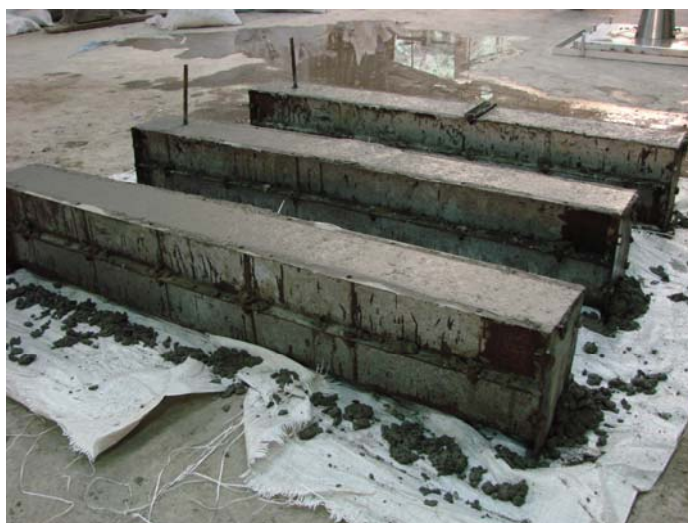
ภาพที่ 30 ตัวอย่างคานคอนกรีตควบคุม
