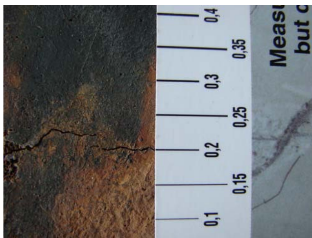
ภาพที่ 44 รอยร้าวของคานจิโอโพลิเมอร์คอนกรีตเนื่องจากการเกิดสนิมของเหล็กเสริม
