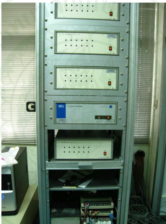
ภาพที่ 21 ตู้ควบคุมภายในประกอบด้วยอุปกรณ์ควบคุมในการวัดและบันทึกผลด้วยคอมพิวเตอร์
