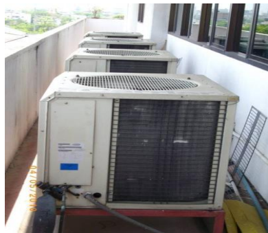
(ก) ระบบปรับอากาศ
