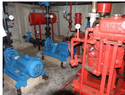
(ข) ระบบปั๊มน้ำ
