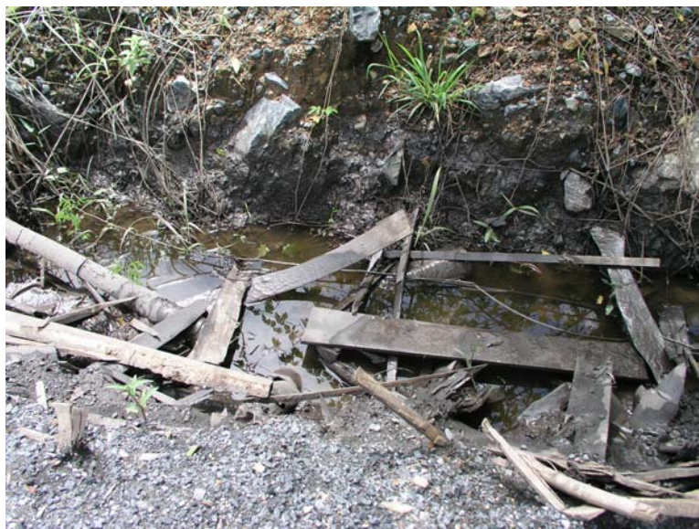
ภาพที่ 21 ไม้ที่กระจัดกระจายออกนอกกองกีดขวางเส้นทางระบายน้ำ
