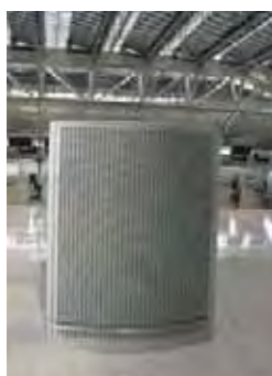
ภาพที่ 191 หัวจ่ายลมเย็นบริเวณพื้นที่สนามบินสุวรรณภูมิ
