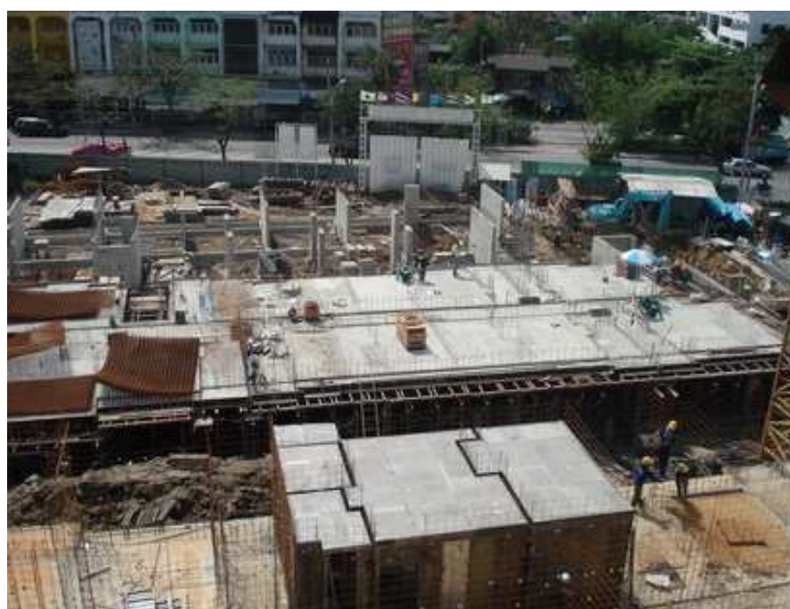
ภาพที่ 6 การเข้าแบบพื้นและผนังระบบไม้แบบไม่วาน(MIVAN)
