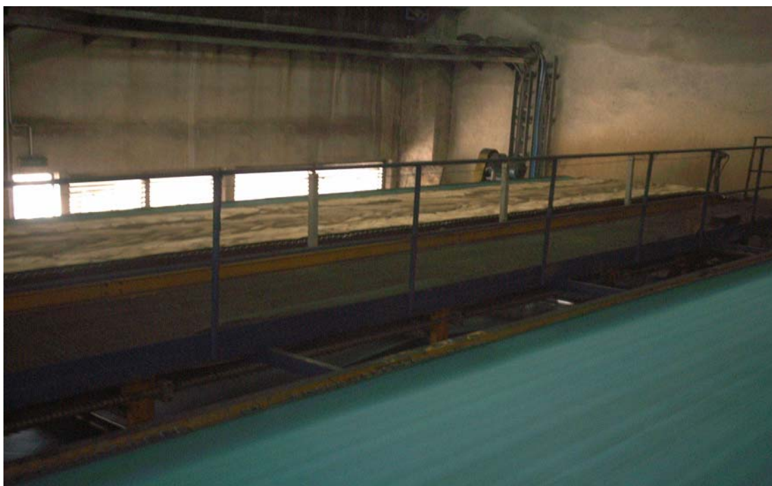
ภาพที่ 6 สายพานระบบแยกน้ำออกจากยิปซัม
