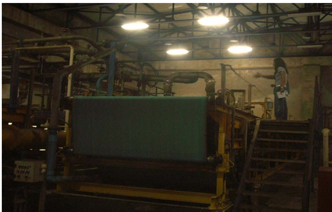
ภาพที่ 5 ระบบแยกน้ำออกจากยิปซัม
