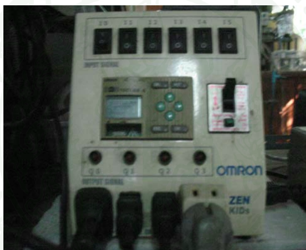
ภาพที่ 13 เครื่อง Programmable Logic Controller (PLC)
