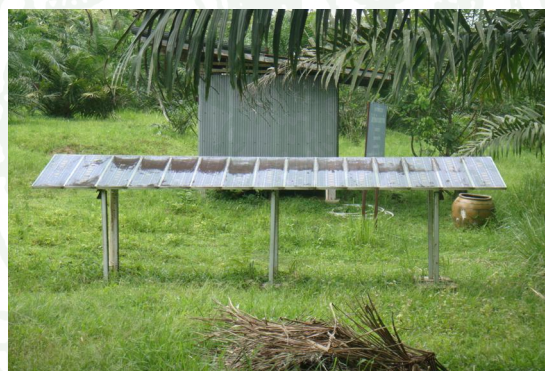
ภาพที่ 5 แผงโซล่าเซลล์เพื่อการผลิตไฟฟ้าพลังงานแสงอาทิตย์ไว้ใช้ภายในหมู่บ้าน
