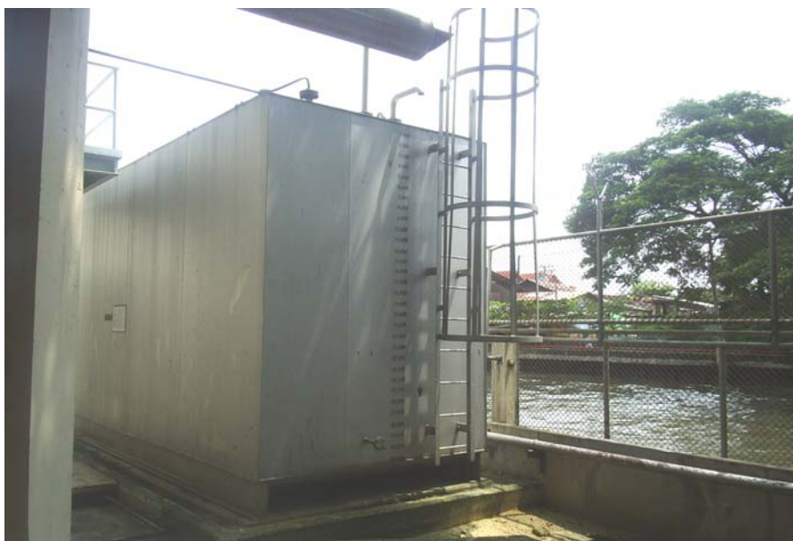
ภาพที่ 14 ถังเก็บน้ำมันดีเซลรูปทรงสี่เหลี่ยม
