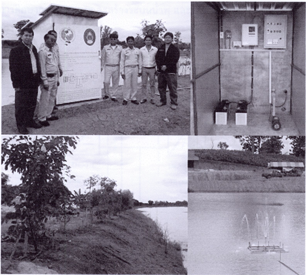
รูปที่ 4.1 แสดงตำแหน่งจุดติดตั้งระบบน้ำพุ และร่นน้ำต้นไม้อัตโนมัติ ด้วยพลังงานแสงอาทิตย์
