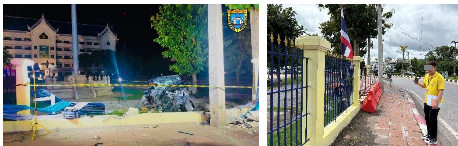
ภาพที่ 5 ลักษณะทางกายภาพของกำแพงศาลากลางจังหวัดกาญจนบุรีบริเวณจุดเกิดเหตุ: ปกติจะมีการด์เรลถูกติดตั้งตามขอบทางเท้า (จุดที่เจ้าหน้าที่ยืนอยู่)
