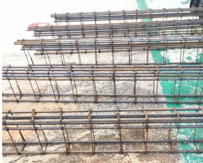
ภาพที่ 3.9 การเตรียมเหล็กเสริมและติดตั้ง
