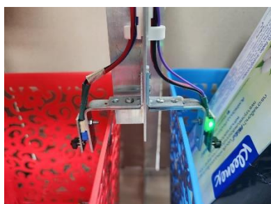
(ก) ถังขยะ GW เต็ม ทำให้ ไฟ LED ของโมดูล IR ติด สว่าง ในขณะที่ถังขยะ HW ยังไม่เต็ม ทำให้ ไฟ LED ของโมดูล IR ดับ
