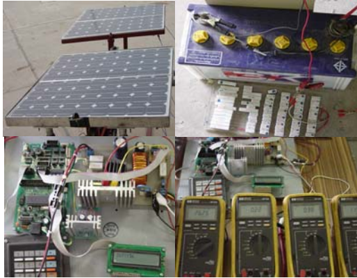
รูปที่ 12 การทดสอบการดึงกำลังไฟฟ้าสูงสุด
