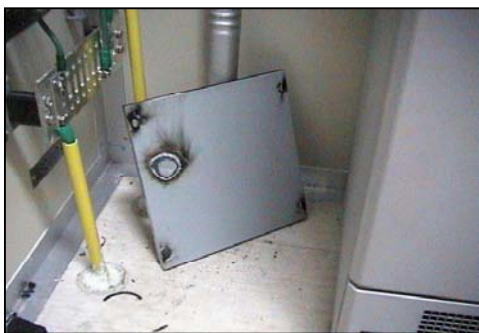
รูปที่ 3 ความเสียหายที่เกิดกับอุปกรณ์ไฟฟ้าในระบบ
