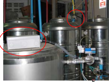
รูปที่ 5 อุปกรณ์ควบคุมวาล์วปล่อยน้ำร้อนเข้าสู่ถังเก็บ
