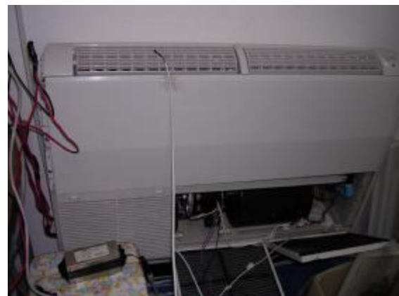
รูปที่ 3.3.1 ตัวเครื่องปรับอากาศที่ใช้ทดสอบ
