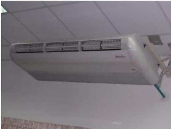
รูปที่ 3.3.2 ตัวเครื่องปรับอากาศที่ใช้ทดสอบ
