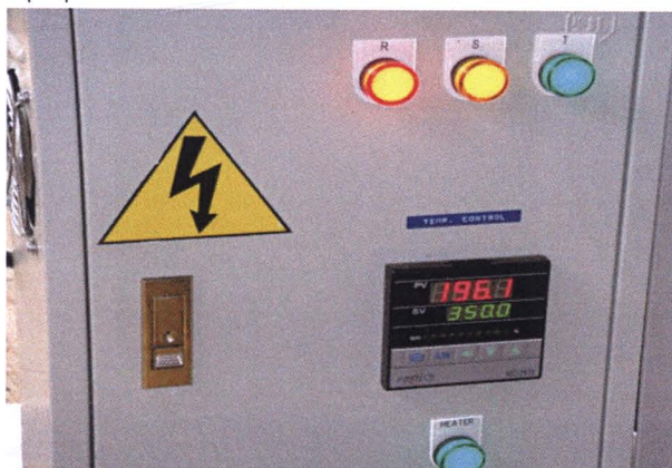
รูปที่ 3.7 ชุดควบคุมอุปกรณ์ทำความร้อน
