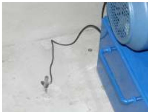
(จ) ตรวจสอบตำแหน่งการติดตั้งและสภาพของสายดิน
