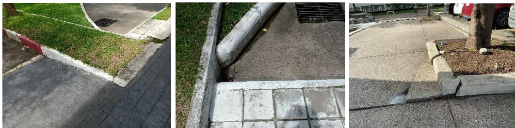
ภาพที่ 23 แสดงอุปสรรคที่พื้นทางเดินภายนอก ลานจอดรถด้านหน้าอาคารคลินิกเวชกรรม สจล. (บันทึกภาพถ่ายเดือนกรกฎาคม พ.ศ. 2565)
