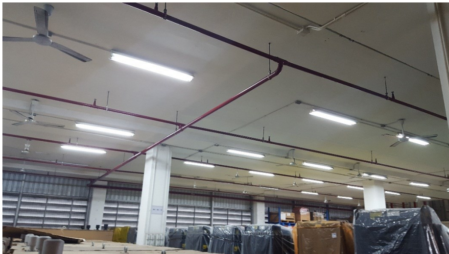
ภาพที่ 4.3 การเปลี่ยนหลอดไฟจากฟลูออเรสเซนต์ให้เป็นหลอดไฟชนิด LED ภายในศูนย์กระจายสินค้าผลิตภัณฑ์และวัตถุดิบอุตสาหกรรม และเทคโนโลยี จ. พระนครศรีอยุธยา
