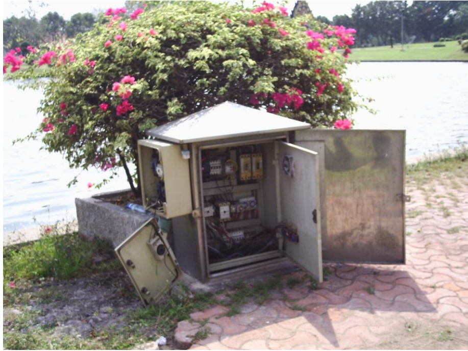
รูปที่ 3.2 ภายในตู้ควบคุมระบบไฟฟ้าที่ต่อสายไฟฟ้าจากโฟโตโวลตาอิกเชื่อมต่อกับระบบจำหน่าย
