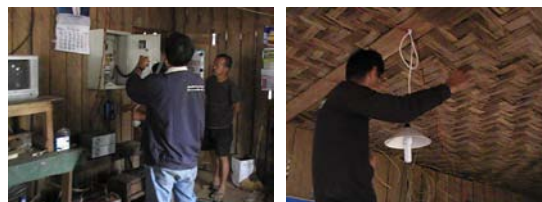
รูปที่ 27 ต่อระบบไฟฟ้าจากกังหันเข้าระบบชาร์จเก็บเพื่อใช้ สื่อสาร และแสงสว่าง
