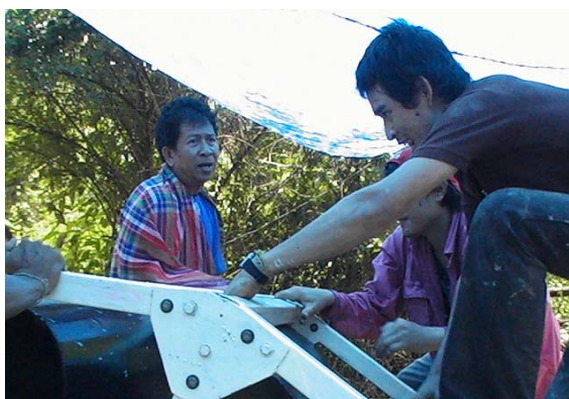
รูปที่ 227 ทดลองหมุนวงล้อน้ำผลิตไฟฟ้าด้วย กำลังคน
