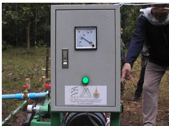
รูปที่ 115 กังหันน้ำส่งแรงขับไปยังเจนเนอเรเตอร์ ผลิตไฟฟ้าออกมาใช้งาน
