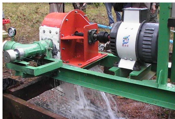
รูปที่ 114 กังหันน้ำส่งแรงขับไปยังเจนเนอเรเตอร์ ผลิตไฟฟ้าออกมาใช้งาน
