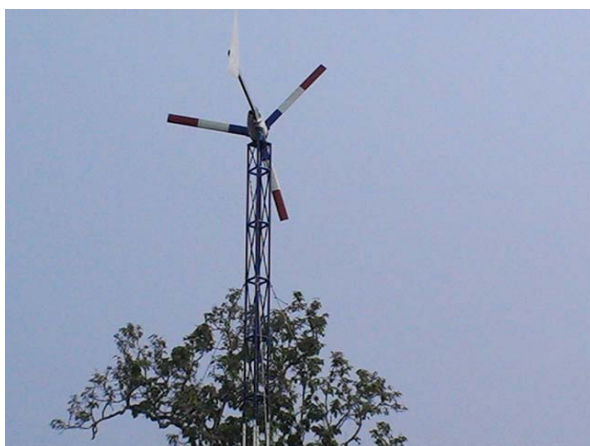
รูปที่ 173 กังหันลมตัวที่ 1 บริเวณด้านข้างฐานทหารพราน BP 16 คอยผาตั้ง อำเภอแม่สะเรียง
