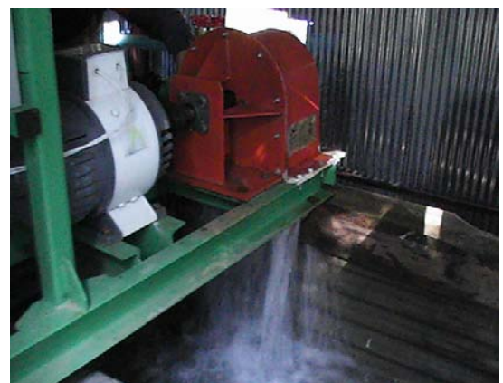
รูปที่ 122 ทดลองเดินเครื่องกังหันน้ำผลิตไฟฟ้า
