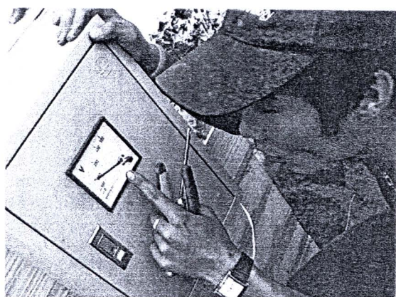
รูปที่ 229 แรงดันไฟฟ้าเพิ่มขึ้นเมื่อวงล้อน้ำหมุนตัว ได้รอบที่กำหนด
