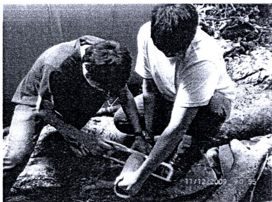
รูปที่ 97 ผู้ช่วยนักวิจัย คัดต้งท่อส่งน้ำจากถัง พักน้ำ
