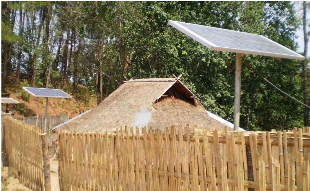
ภาคผนวกที่ 12 การติดตั้งระบบ SHS ในพื้นที่ศึกษา
