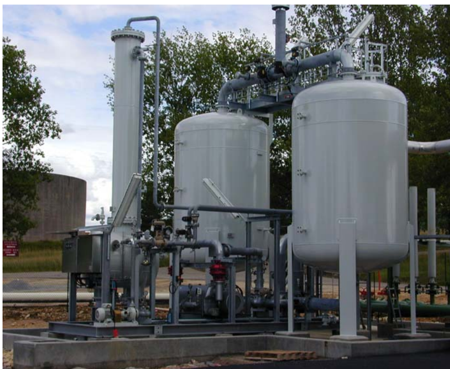
ภาพที่ 10 หน่วยควบคุมไอระเหย่น้ำมันแบบดูดซับ
