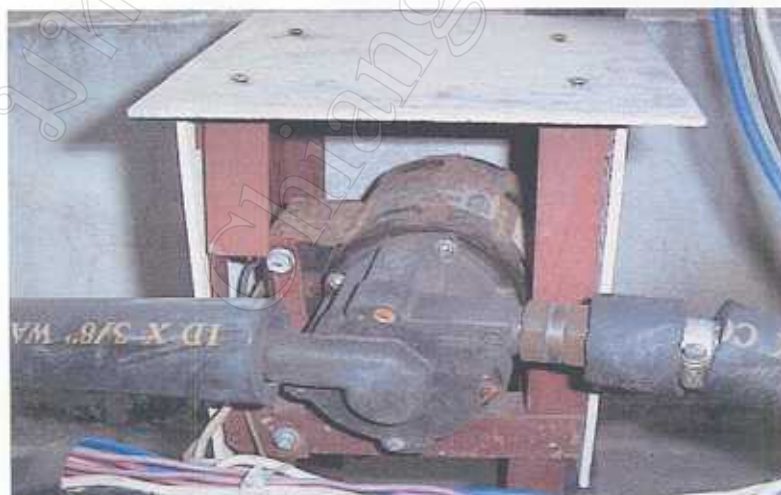
รูป 3.3 ปั๊มน้ำร้อน
