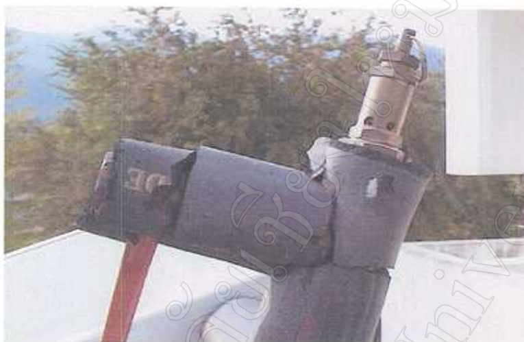
รูป 3.6 วาล์วระบายแรงดันของระบบทำน้ำร้อน
