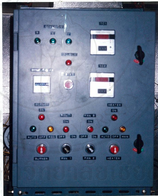
รูป 3.10 แสดงชุดควบคุมทางไฟฟ้า 1
