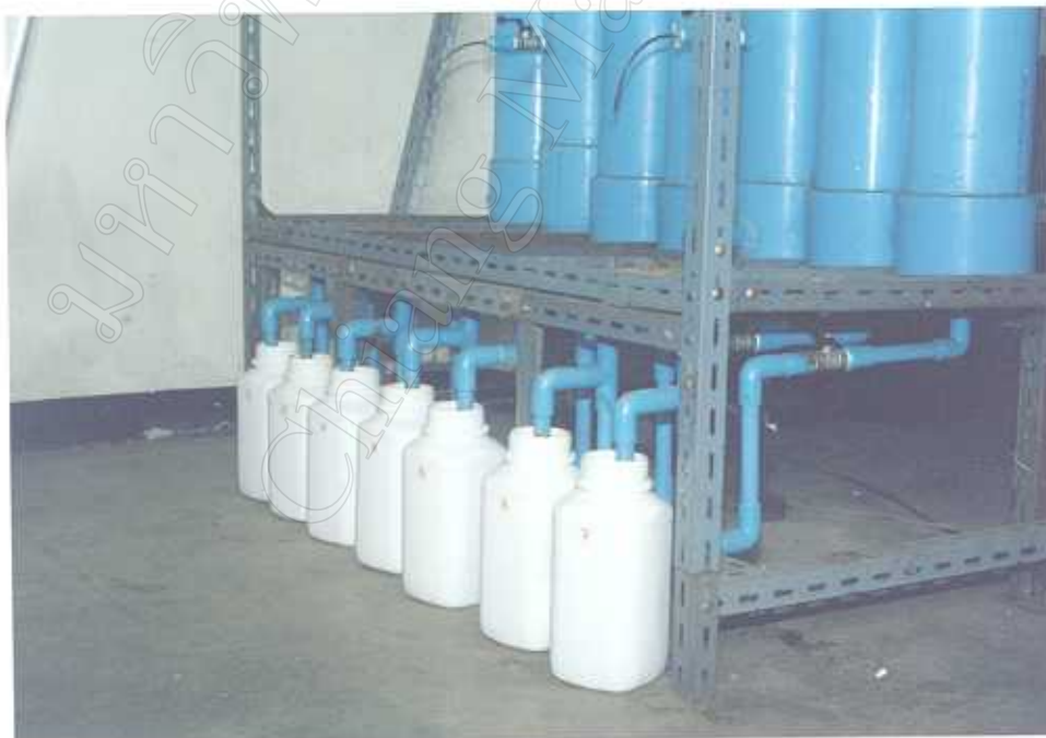
รูปที่ 3.4 ท่อรวบรวมน้ำชะมูลฝอยและภาชนะรองรับ
