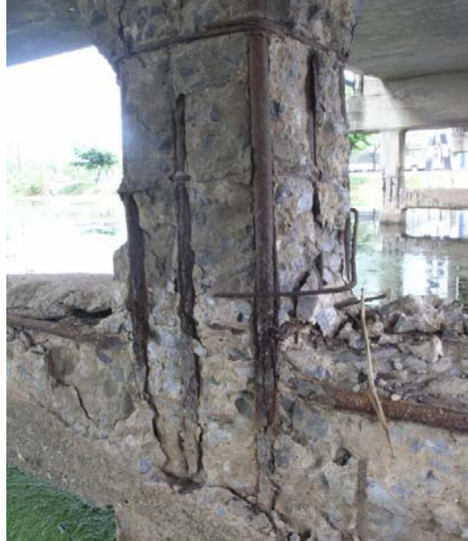
รูปที่ 2.7 สภาวะภายนอกที่ตรวจพบ 1 สะพานบริษัท สากลการทอ จำกัด
