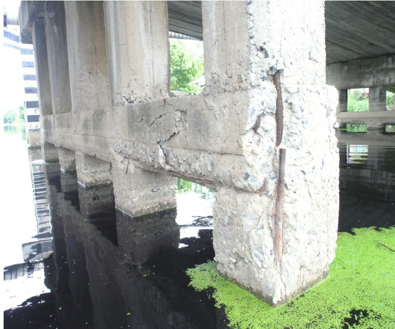
รูปที่ 2.11 สภาวะภายนอกที่ตรวจพบ 1 สะพานโรงเรียนอุ่มอารีวิทยา
