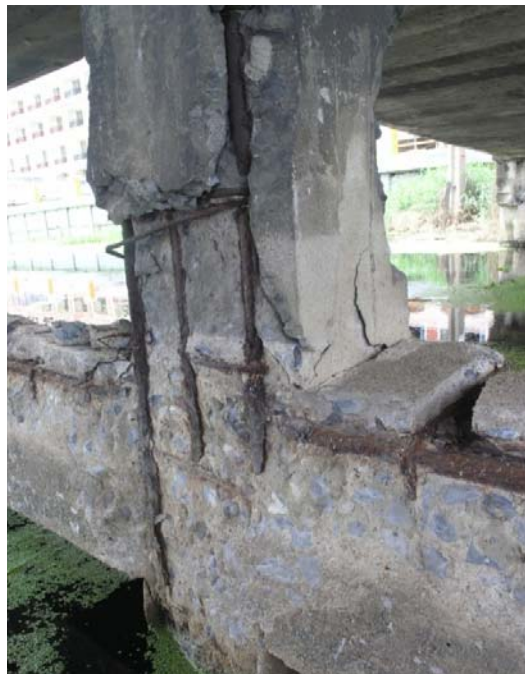
รูปที่ 2.8 สภาวะภายนอกที่ตรวจพบ 2 สะพานบริษัท สากลการทอ จำกัด
