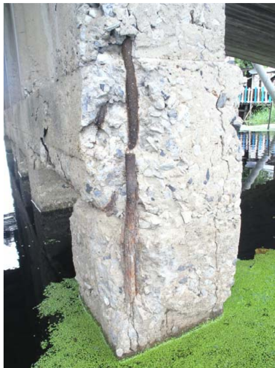
รูปที่ 2.12 สภาวะภายนอกที่ตรวจพบ 2 สะพานโรงเรียนอุ่มอารีวิทยา
