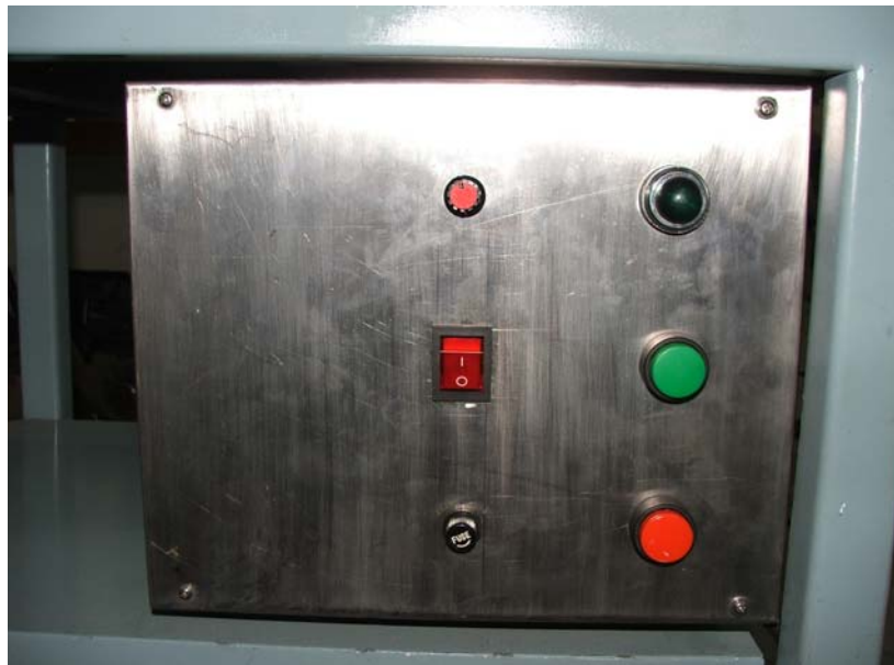
ภาพผนวกที่ ข๑ ชุดควบคุมเครื่องอัดและตัด
