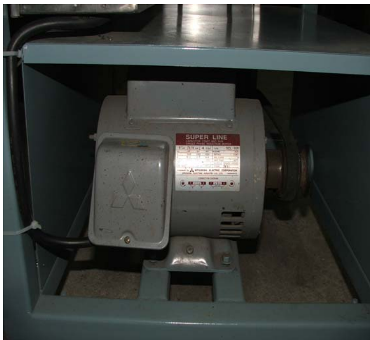
ภาพผนวกที่ ข2 มอเตอร์ต้นกำลัง
