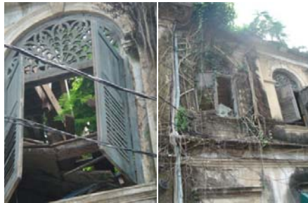
กรอบหน้าต่างมองเห็นหลังคาที่ถล่มลงมาและวัชพืช (อาคารปีกซ้าย)
