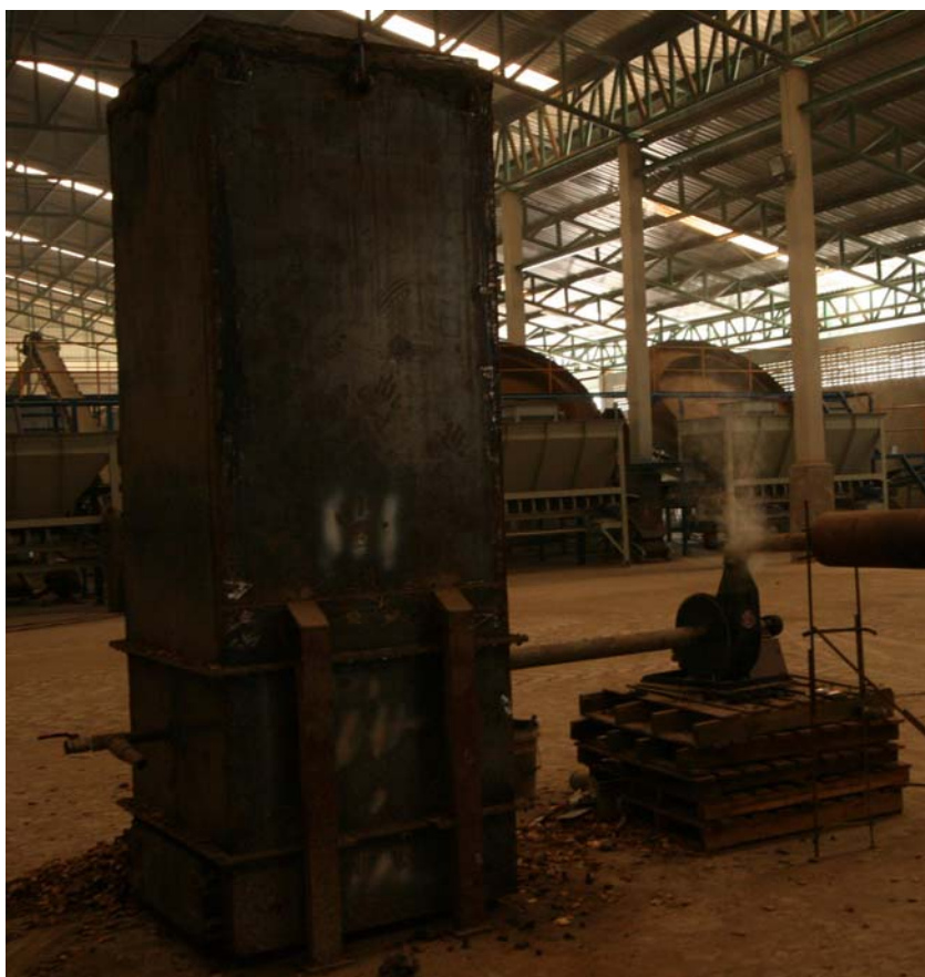
ภาพผนวกที่ ข1 การติดตั้งพัดลมสำหรับป้อนอากาศให้กับเตา
