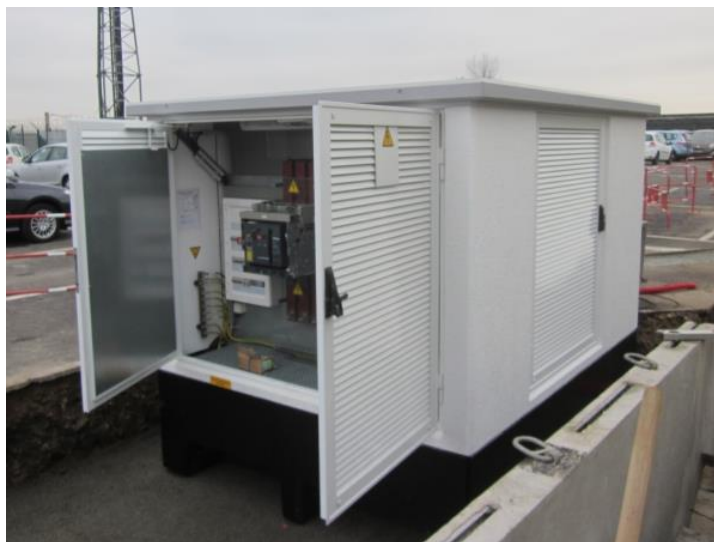
รูปที่ 2 - 3 หม้อแปลงไฟฟ้า (SEL Groupe, 2016)
