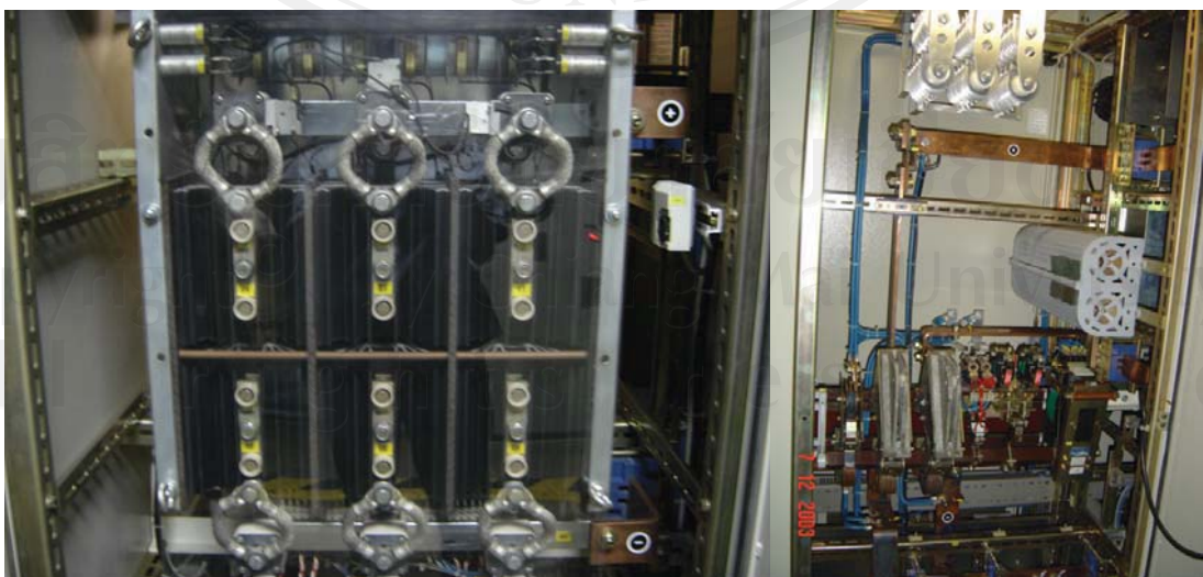
รูปที่ 2.3 อุปกรณ์แปลงแรงดันและจ่ายไฟกระแสตรงให้กับขดลวดเครื่องกำเนิดไฟฟ้า
