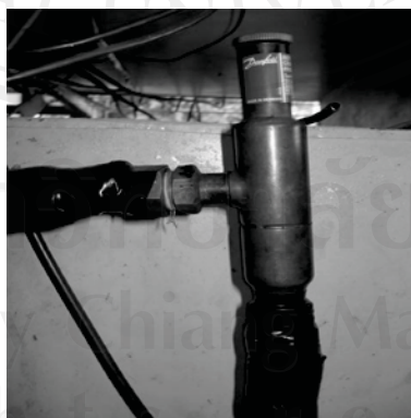
รูป ก 12 ชุดควบคุมแรงดันเครื่องทำความเย็น ( Evaporator pressure regulator : EPR )
