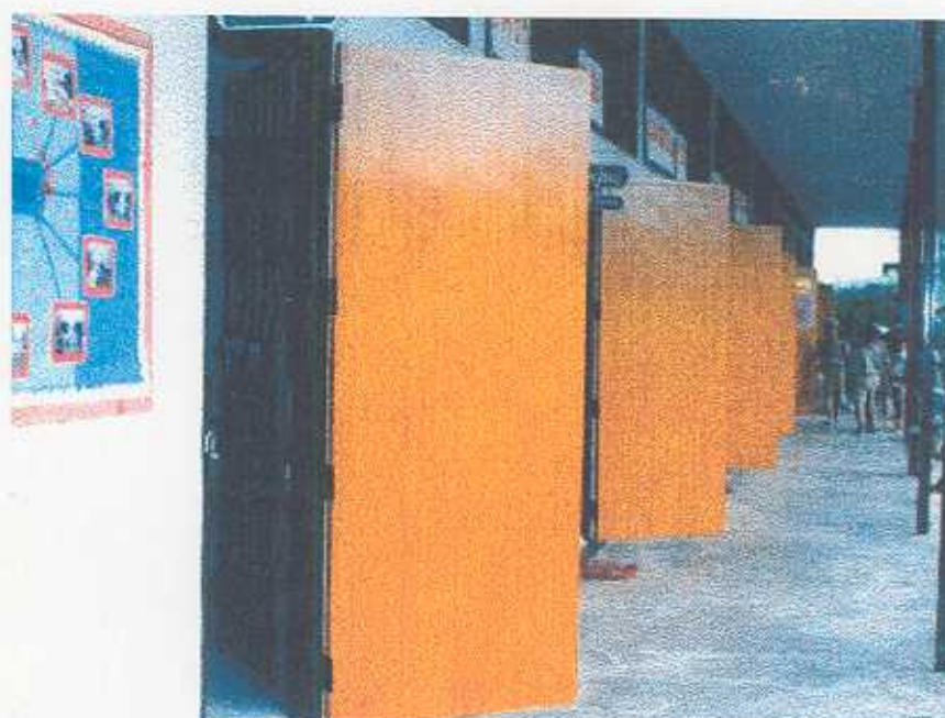
รูปภาพที่ 41 อาคารเรียนแบบ สปช.102/26 ขนาด 4 ห้องเรียน ของ โรงเรียน ค. ที่ได้รับการปรับปรุงแล้ว
