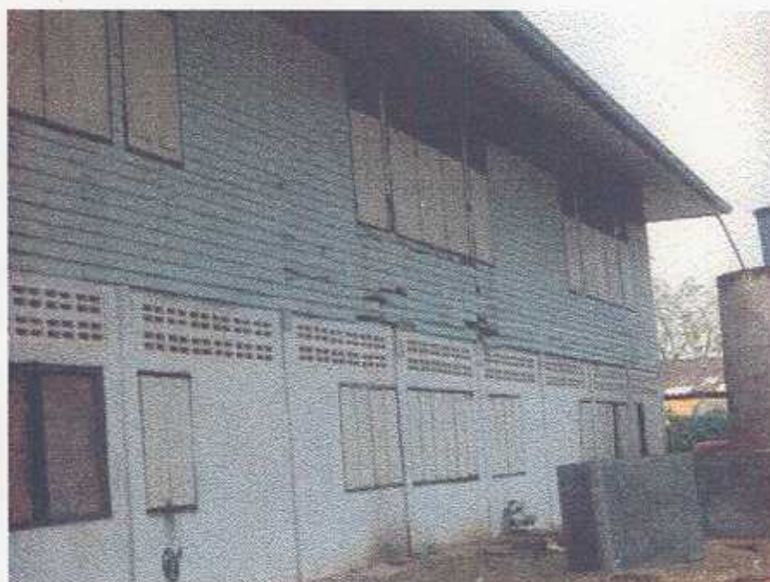
รูปภาพที่ 35 สภาพอาคารเรียนแบบ ป.1 ขนาด 8 ห้องเรียนที่ชำรุดทรุดโทรมของโรงเรียน ค.
