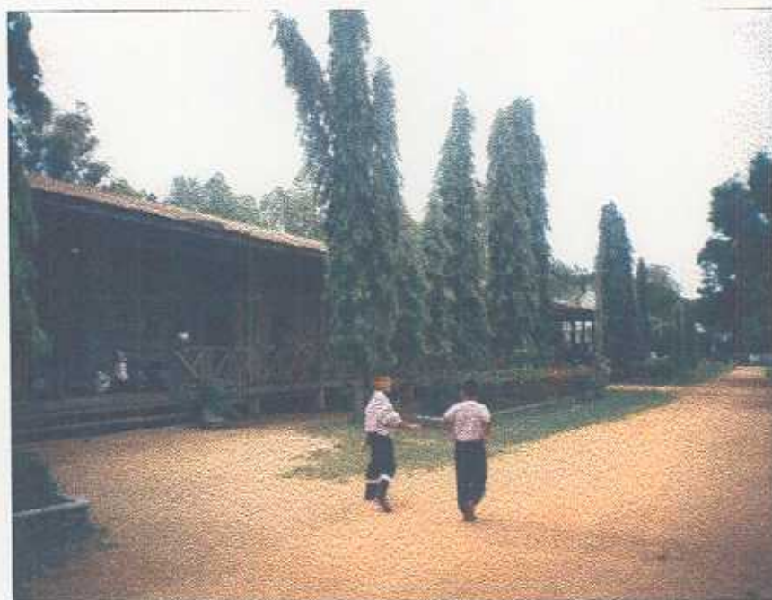
รูปภาพที่ 4 สภาพอาคารเรียนแบบ ป.1. ข ขนาด 7 ห้องเรียนที่เก่าและชำรุด ทรุดโทรมของโรงเรียน ก.
