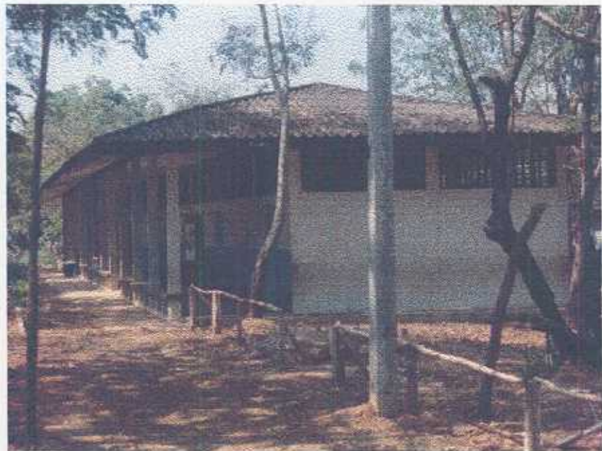
รูปภาพที่ 22 สภาพอาคารเรียนแบบ ป.1 ก. ของโรงเรียน ข. ที่ค่อนข้างเก่า
