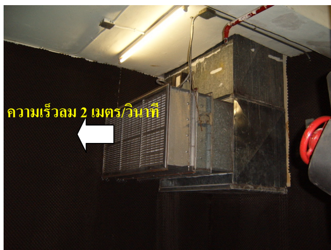
ภาพที่ 9 ช่องอากาศจากภายนอกของอาคาร (Fresh Air)
