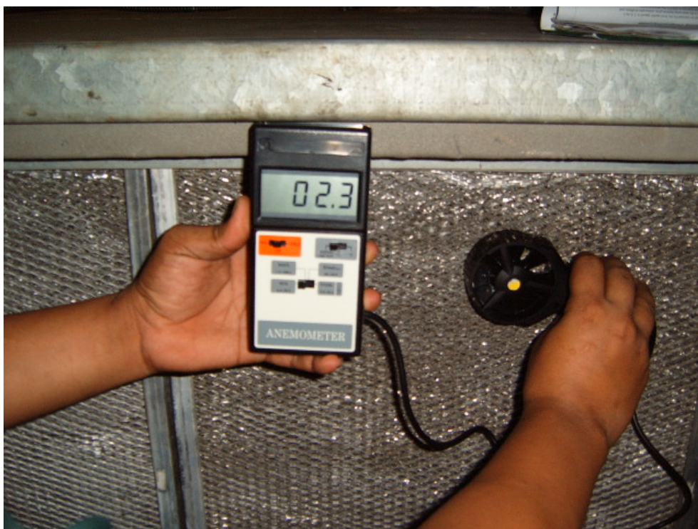
ภาพที่ 14 การวัดค่าความเร็วลมกลับ (Return Air) ของเครื่องส่งลมเย็น
