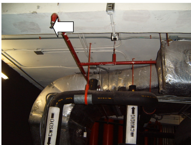
ภาพที่ 10 หัวกระจายน้ำดับเพลิงอัตโนมัติ ที่ติดตั้งภายในห้อง
