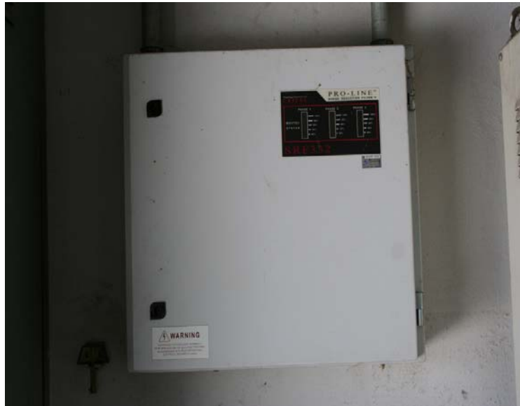
ภาพที่ 57 AC Surge ที่ติดตั้งใช้งานที่สถานีโทรคมนาคม แบบที่1
