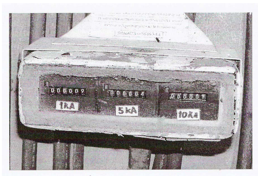
ภาพที่ 61 ตัวอย่างเครื่องวัดฟ้าผ่าที่ติดตั้งใช้งานที่ชุมสายดงหลวง
